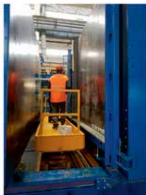
КАССЕТНАЯ УСТАНОВКА с подвижной платформой для обслуживания формовочных отсеков
